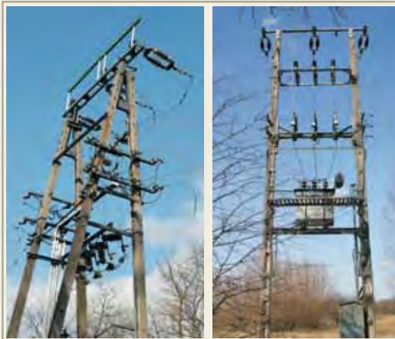
Różne sposoby zapobiegania porażeniom (podest i niebezpieczne odgromniki umieszczone poniżej górnego poprzecznika słupa). Fot. MO i IK
