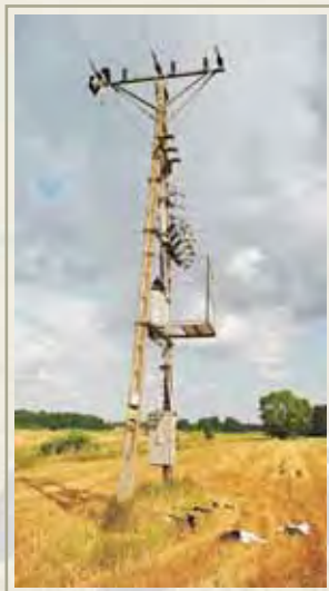
Bociany porażone prądem na stacji transformatorowej. Fot. IK
